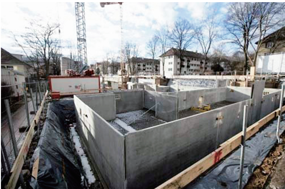
写真1 Stuttgart-Hallschlag 地区におけるシュトゥットガルト式内部開発モデルの建設現場 比較的、社会住宅の多い都市内部地区に、民間開発業者による年齢、階層、用途等によるソーシャルミキシングを目指している。
