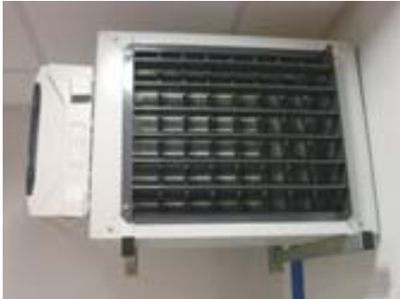
作品乾燥室内天井近くに設置された暖房機
