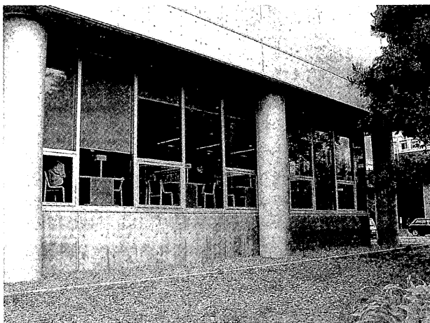
9. 前庭部分より図書館内部を見る：犬走りがなく大地が直接、建物にぶつかる
